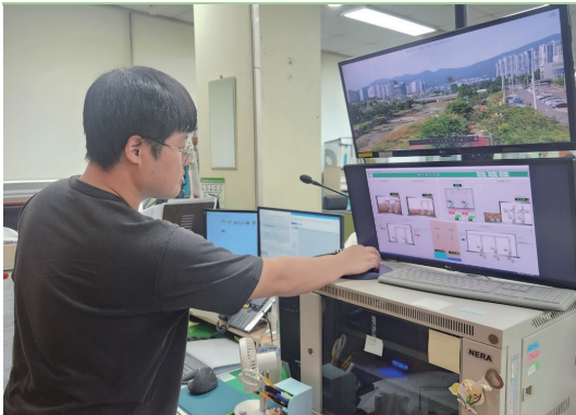
명촌배수장 외 1개소 TM/TC반 제작구매 설치(준공사진)
